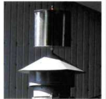
性能調査した換気装置
