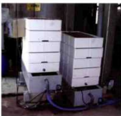
傾斜土槽法による汚水処理
